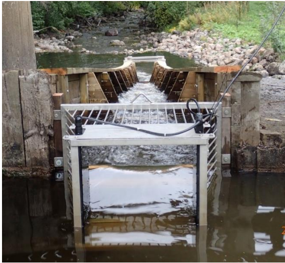
Figur 13 Fiskräknare installerad högst upp i en fiskpassage. Foto: Länsstyrelsen Västernorrlands län
