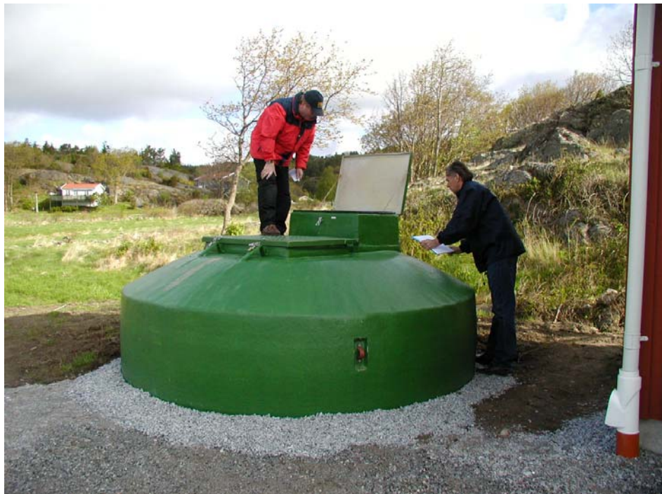
Olsby avloppsreningsanläggning på Tjörn var klar 2003 (gemensamhetsanläggning). Anläggningen utgörs av ett reningsverk från Emendo samt en våtmark i form av leveér på 500 kvm (se även framsidesbild). Anläggningen renar både WC- och BDT-avopp från drygt 40 hushåll. Foto: Maria Hübinette, Länsstyrelsen Västra Götaland
